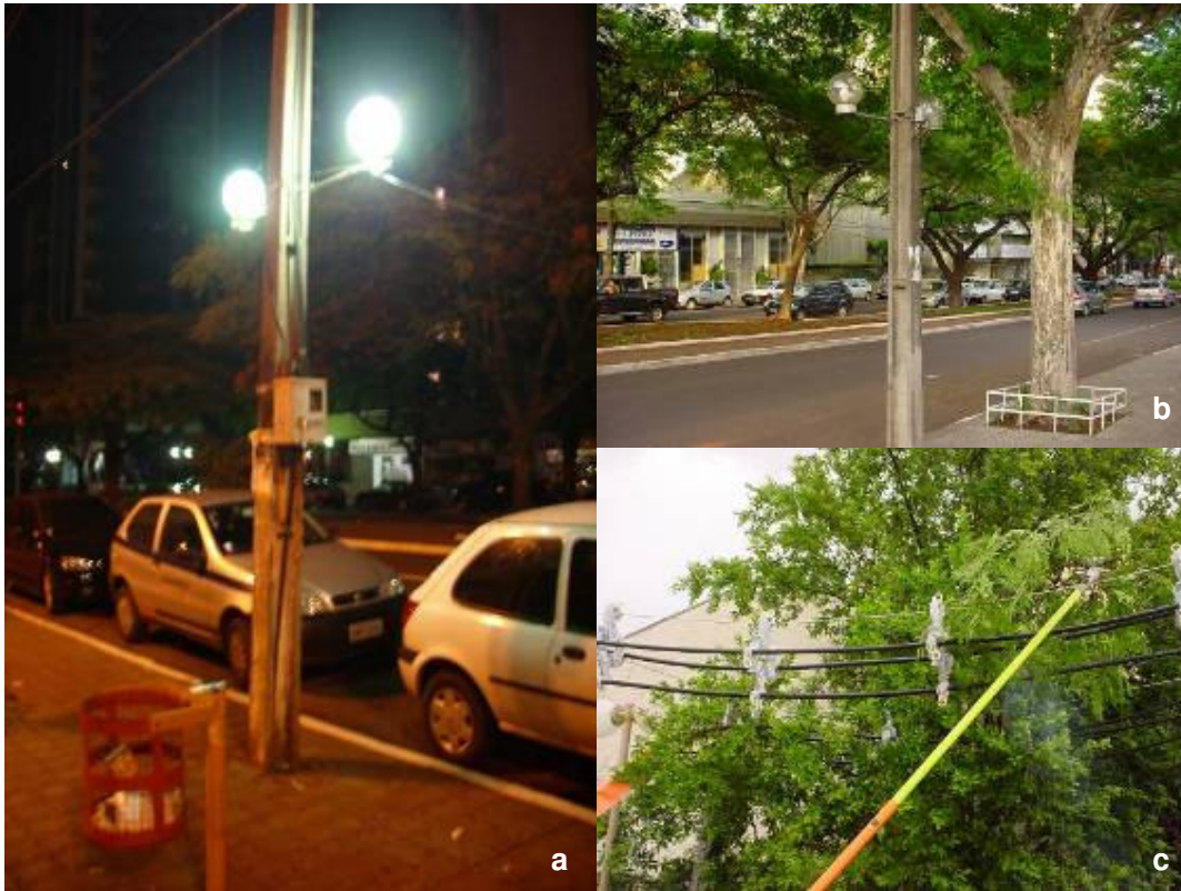
Figura 11. Nestas imagens nota-se como a cidade de Maringá/PR resolveu dificuldades da manutenção de uma iluminação pública eficiente, dos sistemas de distribuição de energia e da conciliação com a arborização de porte alto: a e b- rebaixando a iluminação e c- protegendo a fiação aérea.
